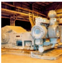
澳大利亚的Alcan Gove项目使用4台Geho活塞隔膜泵输送赤泥。
