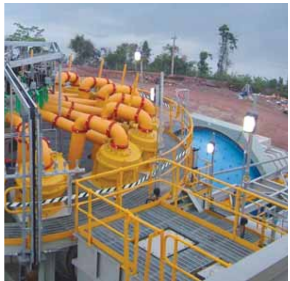
Planta de Cobre – Ciclones Cavex® em circuito fechado de moagem
