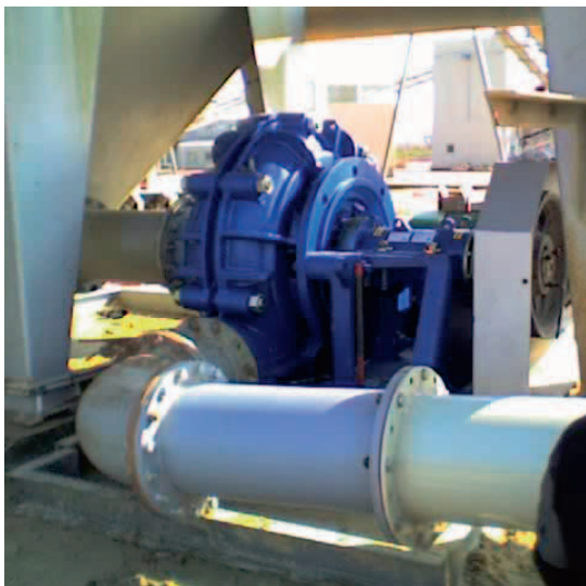
Ci-contre : 1 pompe 12/10 FAH pour alimentation d'un cyclone en sablière.
