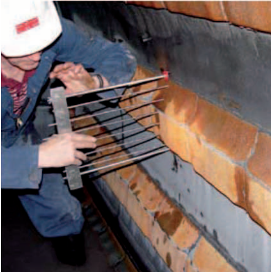
Ci-dessus : prise d'une mesure d'usure pour prévoir la durée de vie.
