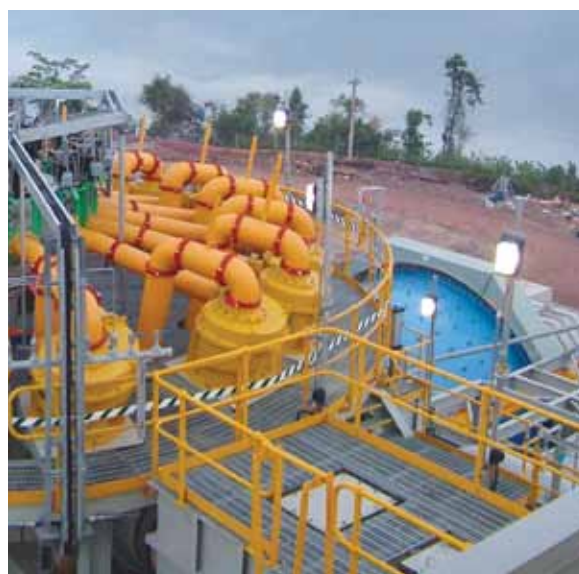
Planta de Cobre – Ciclones Cavex® em circuito fechado de moagem
