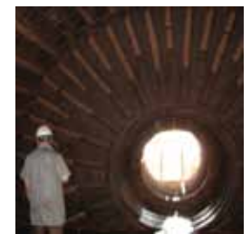
Revestimento com caps metálicos no cilindro e espelho de alimentação.
