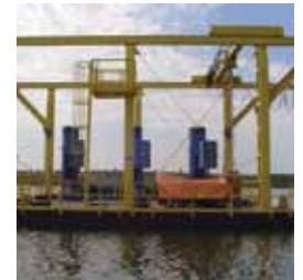
Bombas Turbina para captação de água montadas sobre balsa.
