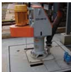
Bomba vertical em operação no processo de polpa de minério.
