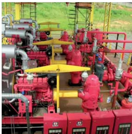
Acima: Captação de Água Recuperada
