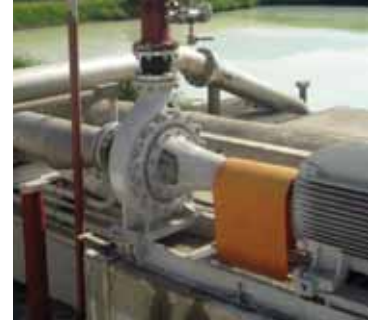
Captação de Água Recuperada
