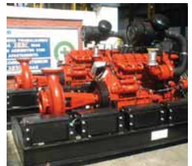
Combate a Incêndio
